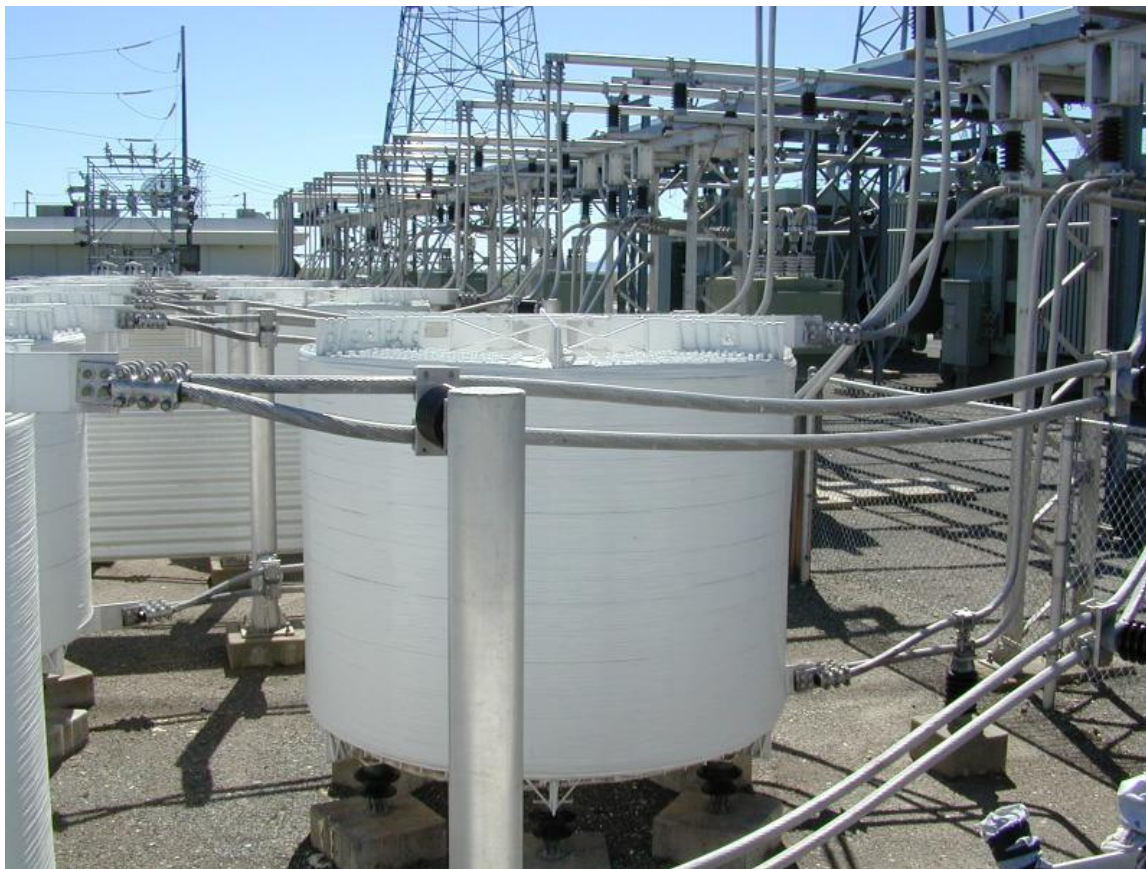
Reactores de derivación
