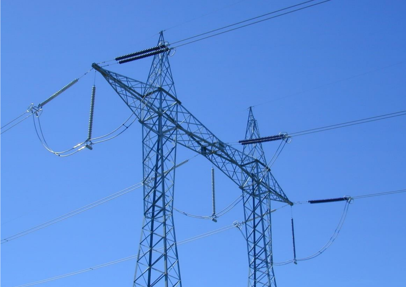
Torre de celosía de acero de 500 kV
